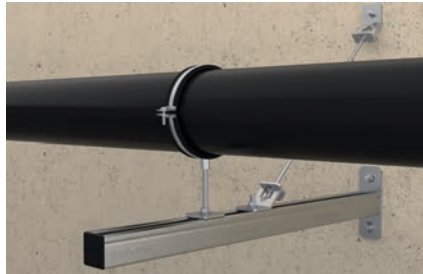
Schweres Abwasserrohr stehend auf Konsole
