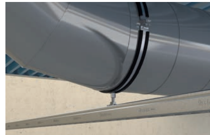
Tragekonstruktion für Lüftungsanlagen
