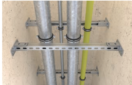
Rohrbefestigung im Fluchtbereich
