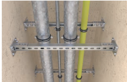
Rohrbefestigung im Fluchtbereich
