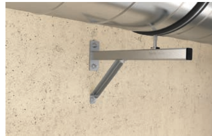
Lüftungsrohrbefestigung an der Wand
