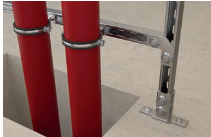
Abflußrohrbefestigung im Steigstrang
