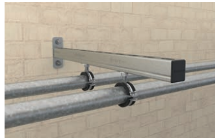
Rohrbefestigung an Konsole
