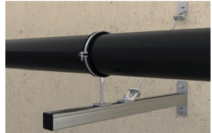
Schweres Abwasserrohr stehend auf Konsole
