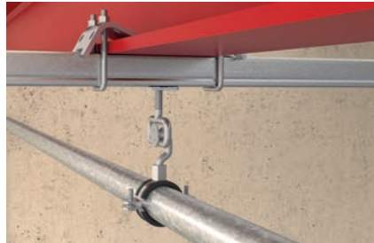
Schiene an Stahlträger
