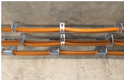
Kabelbefestigung an der Decke
