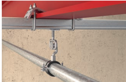
Schiene an Stahlträger
