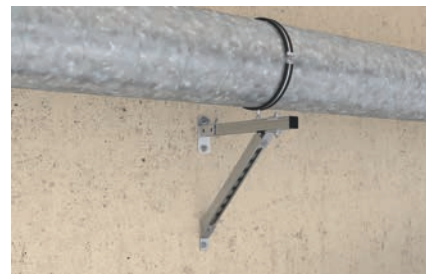
Lüftungsrohr auf Wandkonsole
