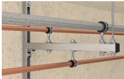
Konsolenkonstruktion mit Schienen
