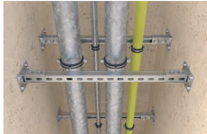
Rohrbefestigung im Fluchtbereich
