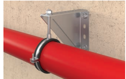
Schweres Abwasserrohr hängend an Winkelkonsole
