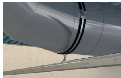
Tragekonstruktion für Lüftungsanlagen
